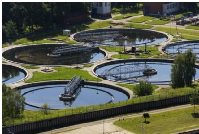
Fig 41: Lug uitsig van die stoor tenks in 'n riool plant
